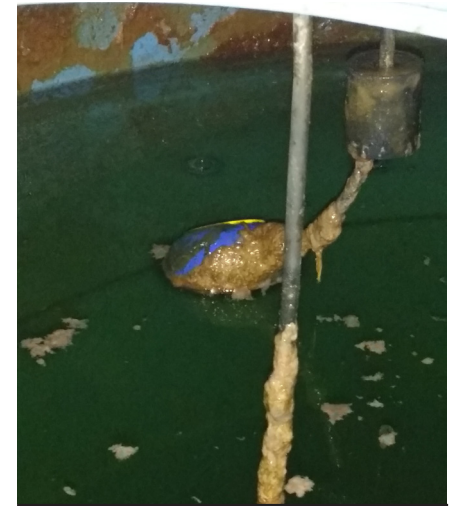
Vervuiling in de buffertank
